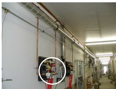
Abb. 14: Falsch - fehlende Isolierung der Versorgungsvorläufe
